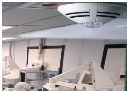
دتکتور نصب شده در سقف
